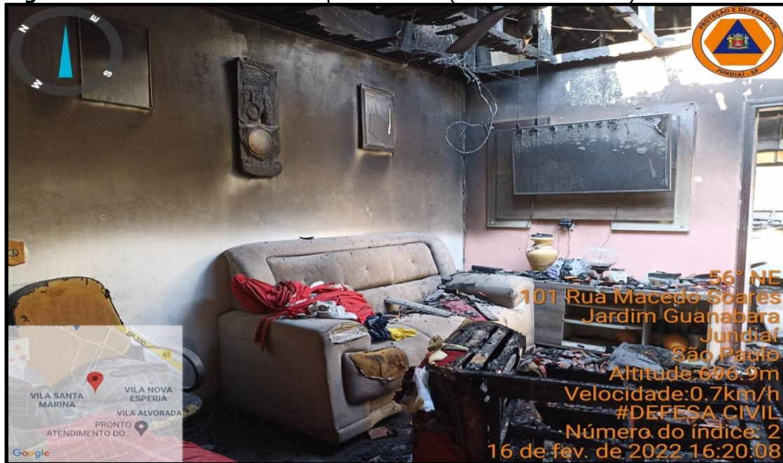
Figura 8 – Residência danificada por incêndio (Jardim Guanabara)
