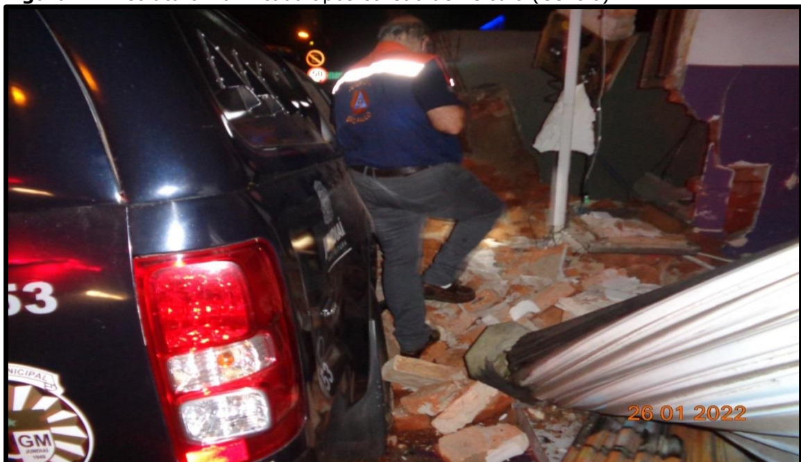
Figura 7 – Estrutura Danificada após colisão de veículo (Centro)
