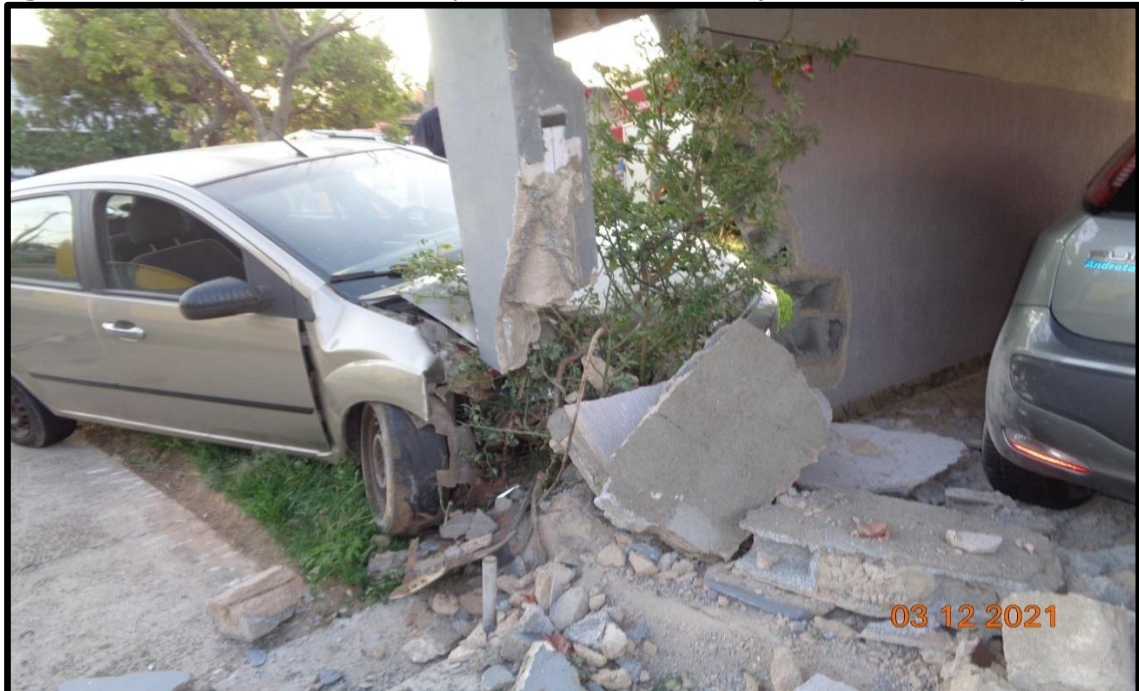
Figura 6 – Estrutura danificada após colisão de veículo (Jd. Novo Horizonte).
