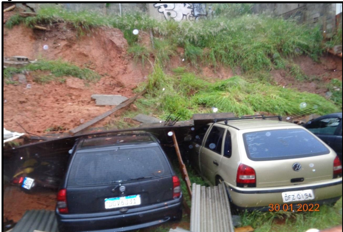
Figura 1 – Deslizamento de terra com queda de muro de arrimo.
