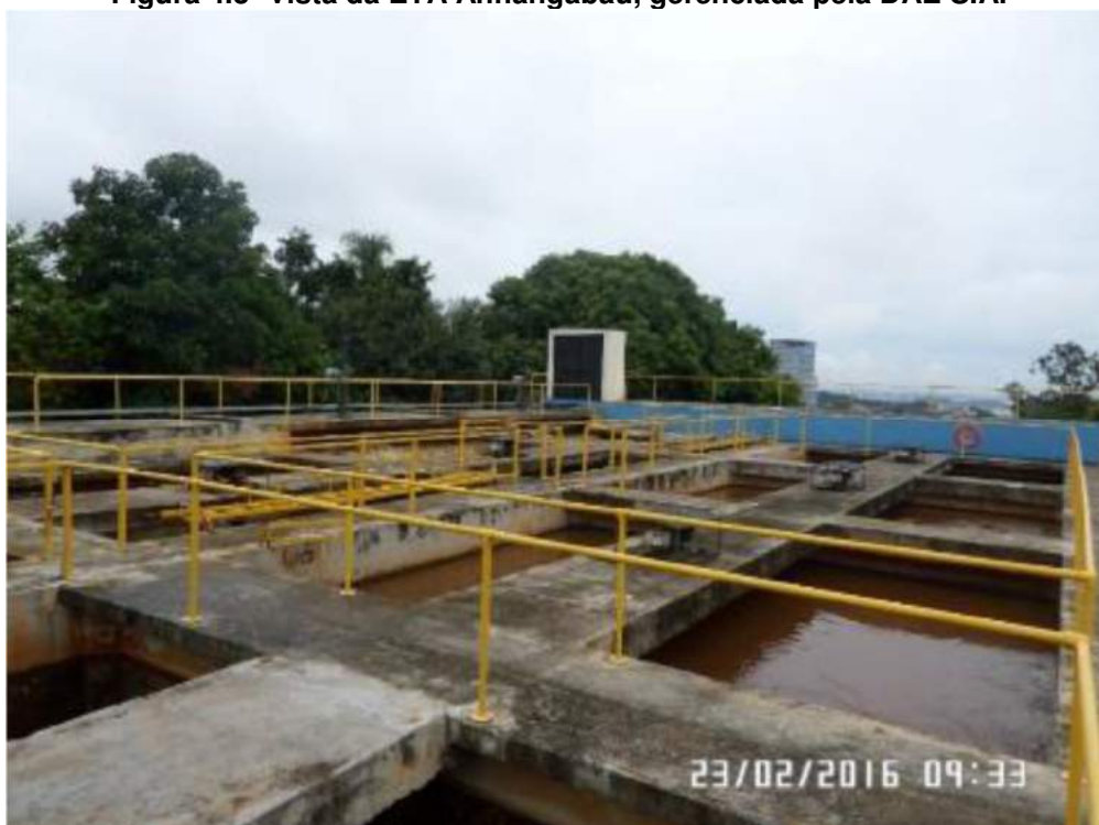
Figura 4.3- Vista da ETA Anhangabaú, gerenciada pela DAE S.A.
