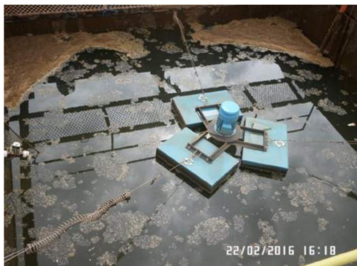
Figura 4.19 - Tanques de aeração da ETE Fernandes
