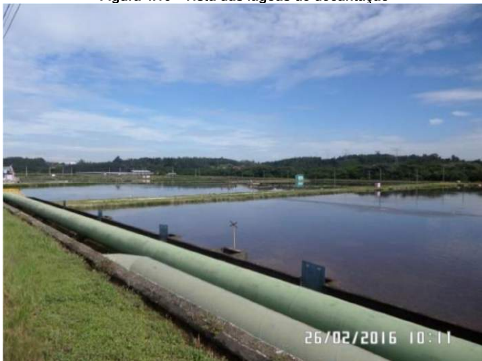
Figura 4.16 - Vista das lagoas de decantação
