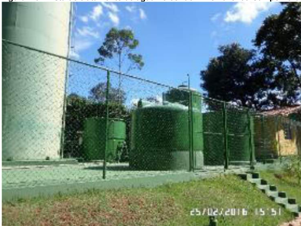
Figura 4.6 - Vista do tratamento de água no condomínio Fazenda Campo Verde
