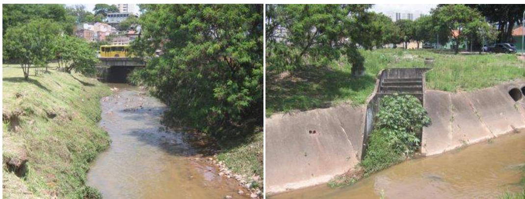
Figura 6.4 - Rio Guapeva – Presença de entulho e obstruções
