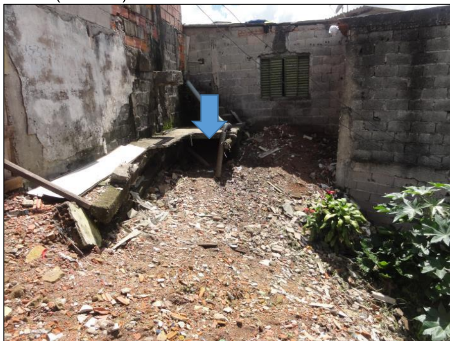
Figura 57 – Ponto de vazamento de esgoto e lançamento de água servida (Seta Azul).
