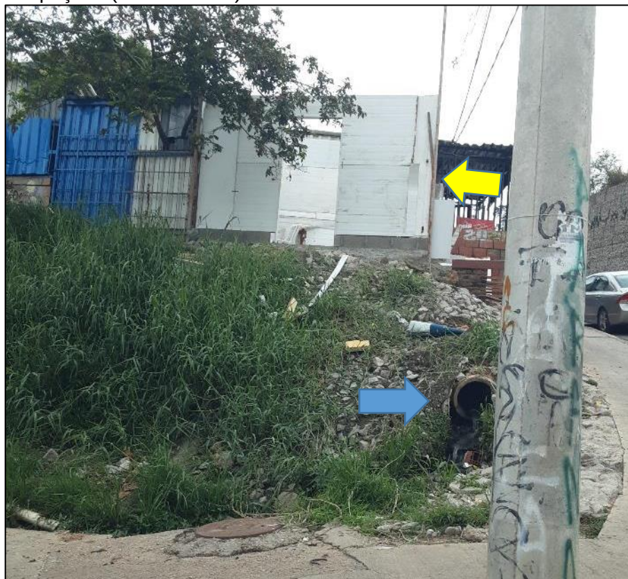
Figura 78 – Lançamento de esgoto in natura (seta azul) e novas ocupações (seta amarela).
