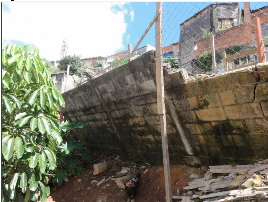
Figura 62 – Muro inclinado em talude de aterro.
