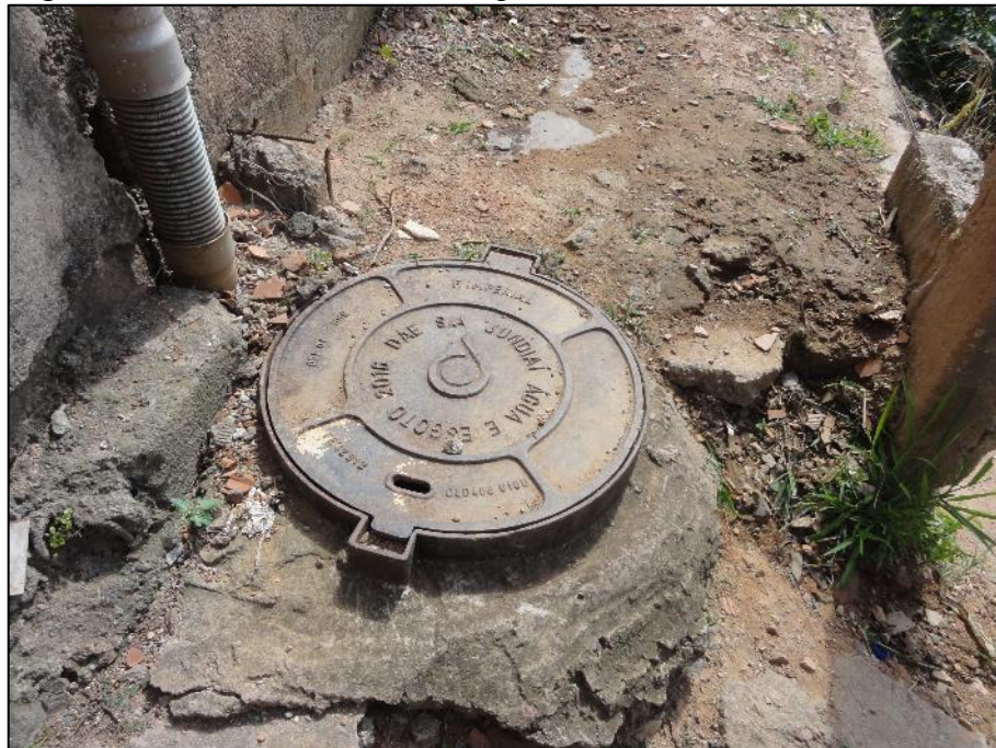
Figura 11 – Rede de coleta de esgoto em via.
