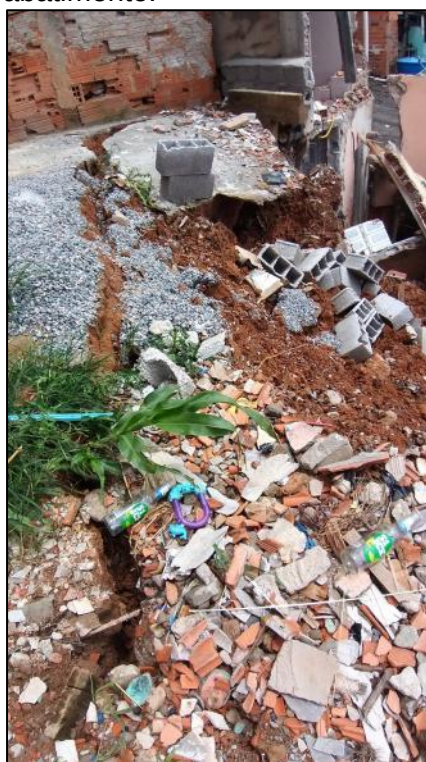
Figura 70 – Observar a trinca no terreno e o degrau de abatimento.
