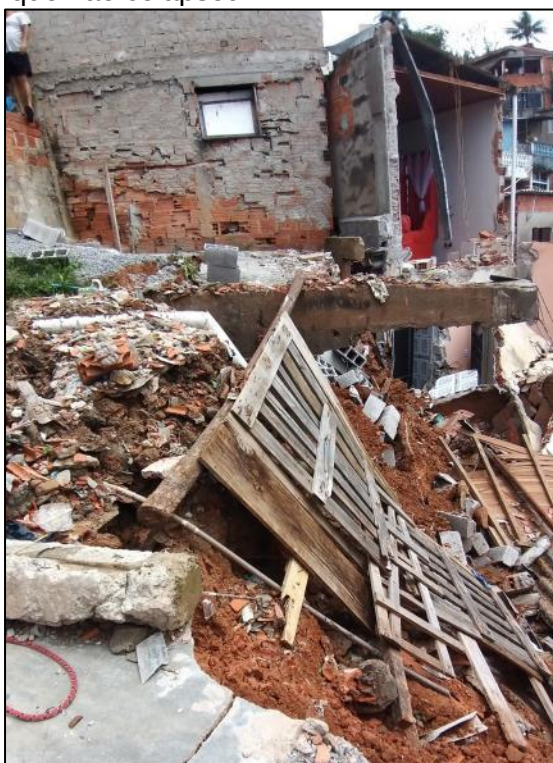
Figura 68 – Vista de parte da moradia que não colapsou.
