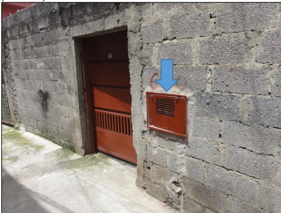
Figura 9 – Abastecimento de água. Hidrômetro instalado pelo DAE (Seta Azul).
