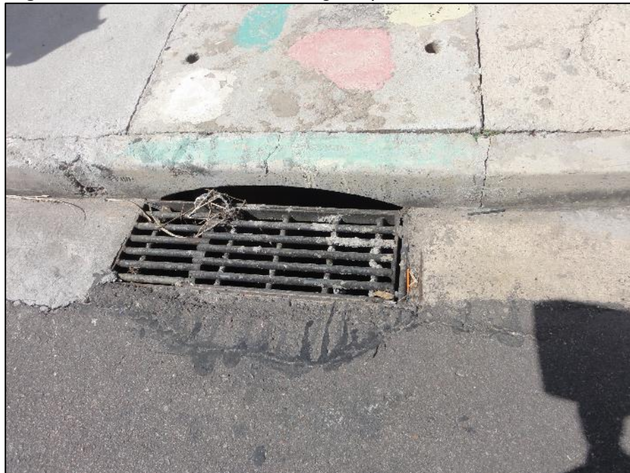
Figura 15 – Sistema de coleta de águas pluviais. Boca de lobo.
