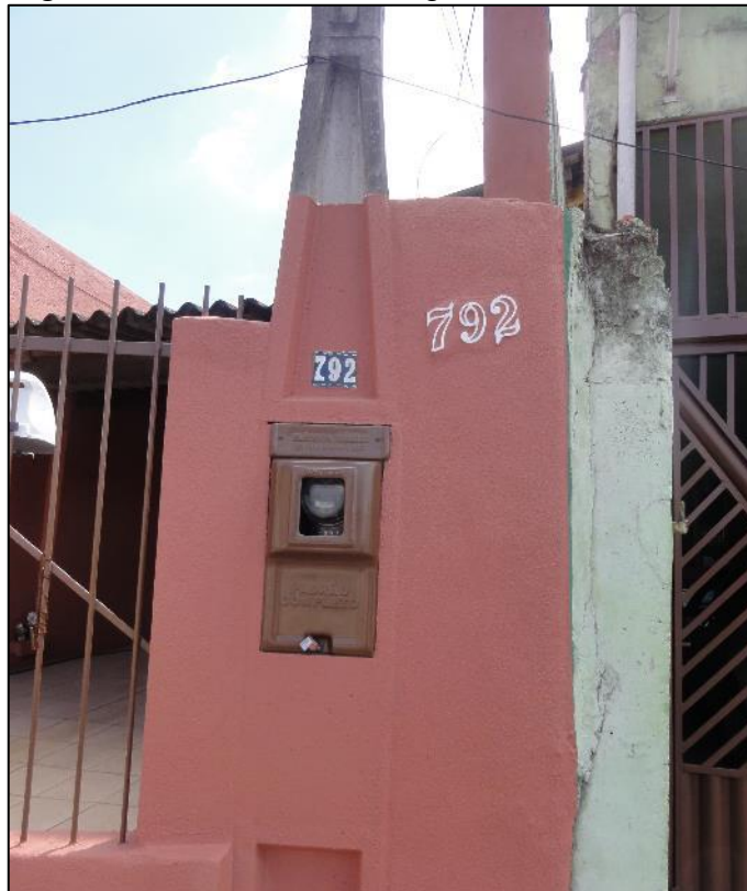
Figura 13 – Medidor de energia elétrica da CPFL.
