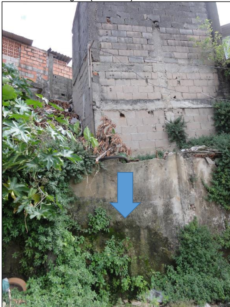
Figura 58 – Notar a umidade na parede em função do vazamento de esgoto (Seta Azul).
