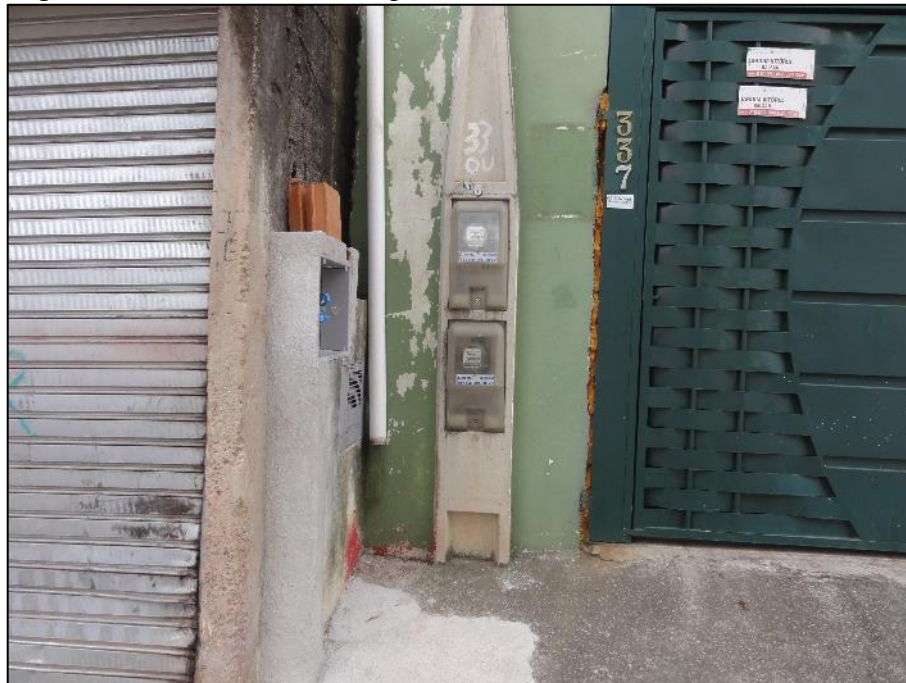
Figura 13 – Medidor de energia elétrica da CPFL.
