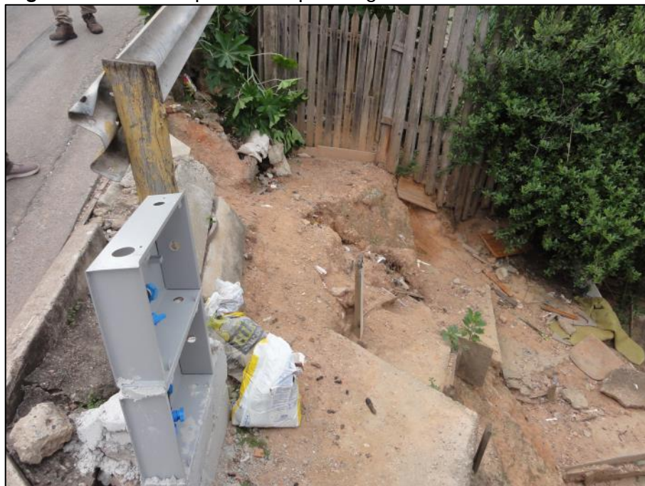
Figura 68 – Erosão provocada pelas águas da via.
