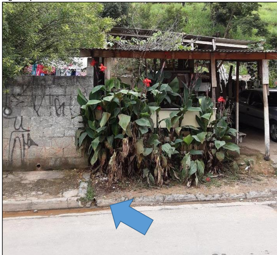
Figura 30 – Evidências de água aflorante na rede de drenagem de águas pluviais.
