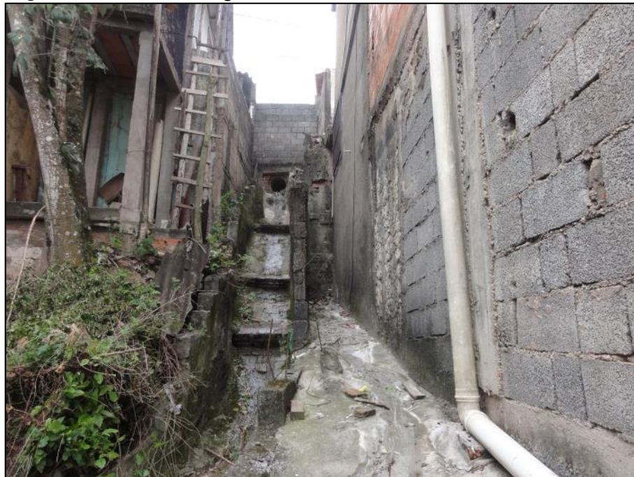
Figura 64 – Escada d'água danificada.
