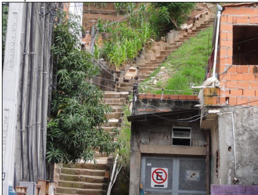
Figura 52 – Observar a ausência de sistema de drenagem e as condições do acesso.
