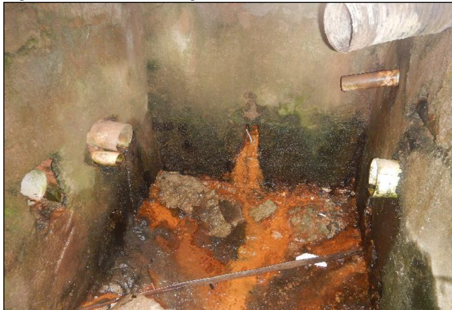
Figura 29 – Evidências de água aflorante em boca de lobo.
