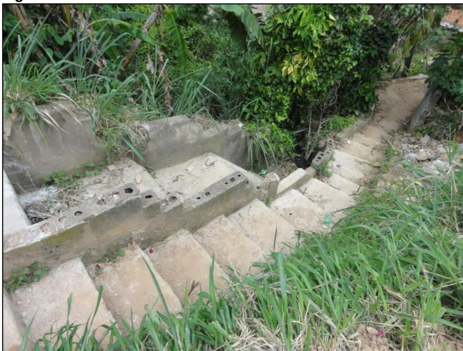
Figura 60 – Escada de acesso sem corrimão.
