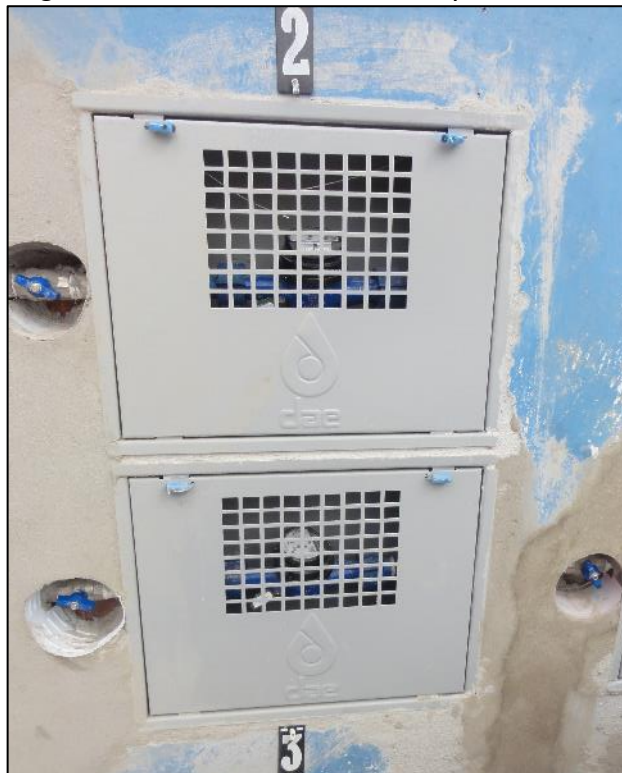
Figura 9 – Hidrômetros instalado pelo DAE
