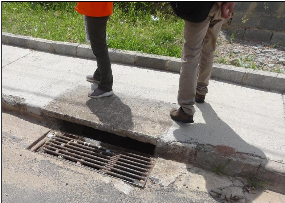
Figura 15– Boca de lobo.
