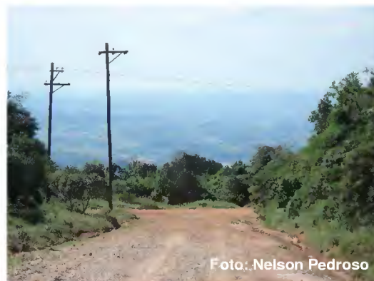
Foto 3.33. Postes com fiação elétrica do loteamento “Serras da Ermida”.
