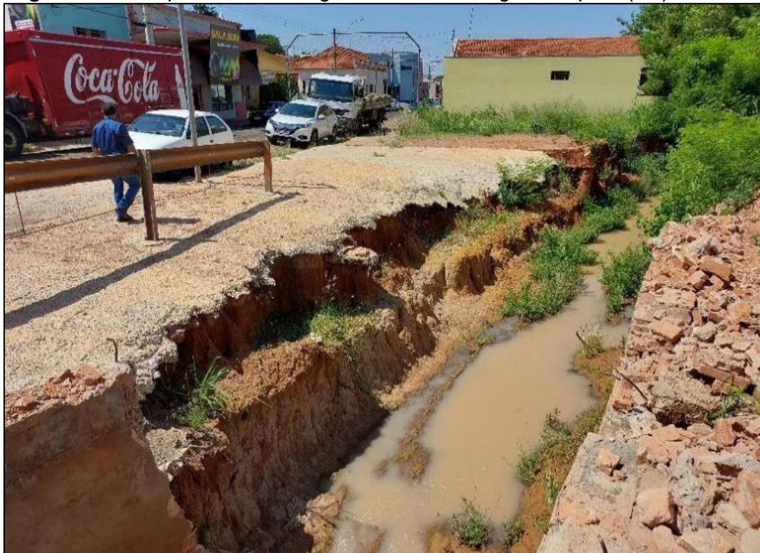
Figura 19 – Solapamento de margem em talude marginal, Itápolis (SP).
